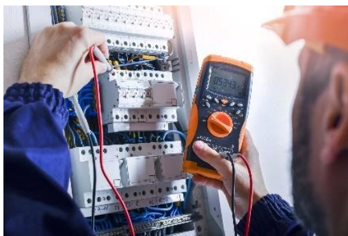
Imagen: Mantenimiento eléctrico preventivo
